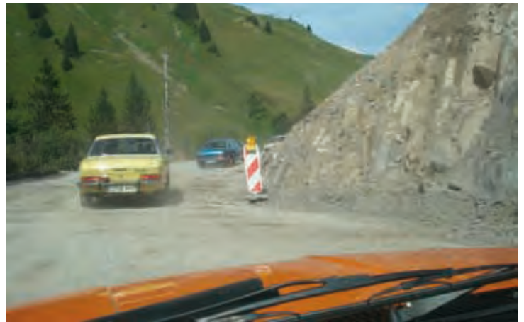
Nicht dass wir über Schotterstraßen gefahren wären; es war nur eine Baustelle
